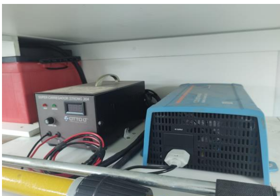
Inversor e Carregador de Baterias
