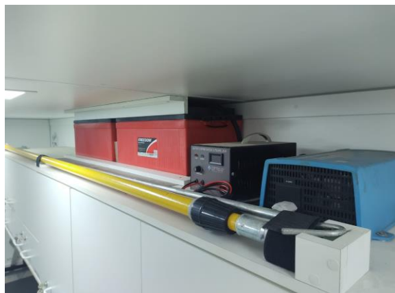
Inversor, Carregador de Baterias e Baterias
