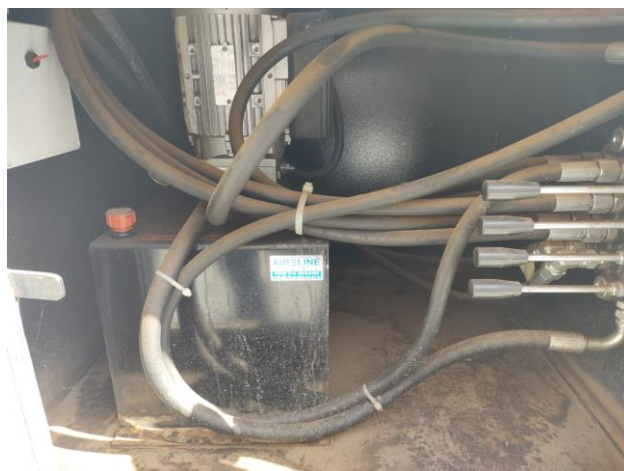
Detalhe da unidade hidráulica
