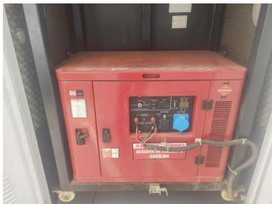
Gerador de energia
