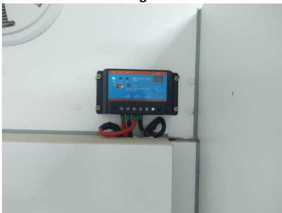
Controlador de carga de luz
